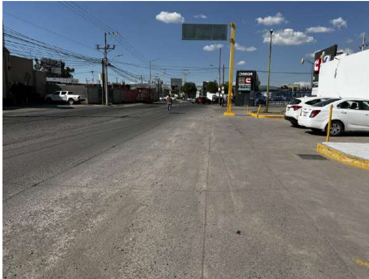
Imagen 11. Estado del pavimento del Blvd. Transportistas
